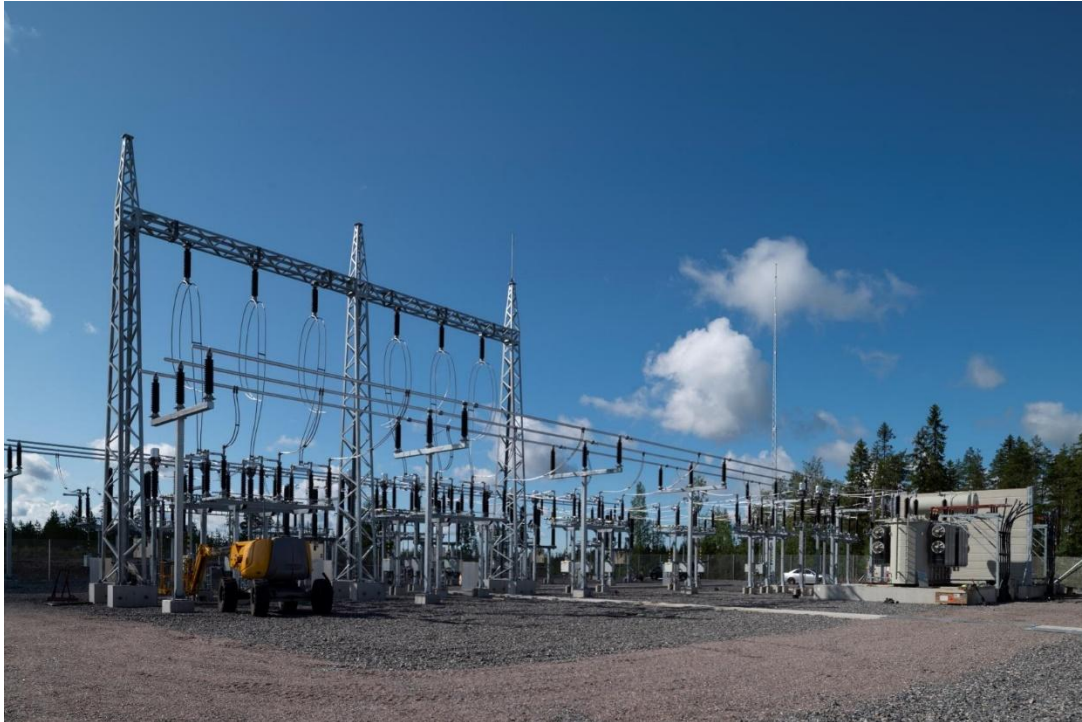
Kuva 5-5. Esimerkki tuulivoimahankkeen sähköasemasta. © Ilmatar Energy Oy.
